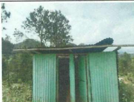
Foto 4: Sanitarios con daño en puertas.
