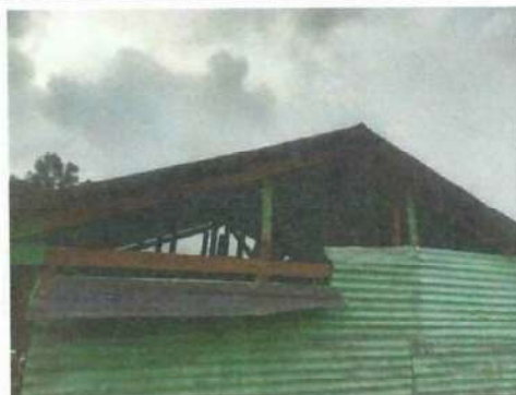
Foto 2: Vista de la cocina con daño en paredes.
